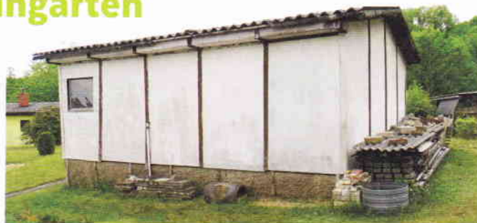
Eine klassische Laube aus DDR-Zeiten, Dach und Wände sind mit Asbestplatten verkleidet. Hinter der Laube wurden beschädigte Wellasbestplatten als Abdeckung für Baumaterial verwendet. Asbestfasern lösen sich zusammen mit abblätternder Farbe und durch das Beschweren mit Steinen. Hier kann nur noch alles fachgerecht entsorgt werden, um Gesundheitsschäden vorzubeugen!
